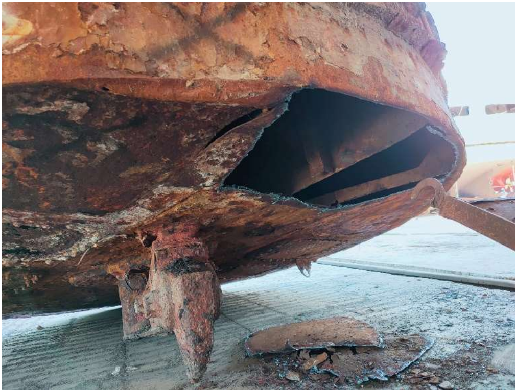
Gambar 1. Korosi yang terjadi pada pelat mooring buoy
