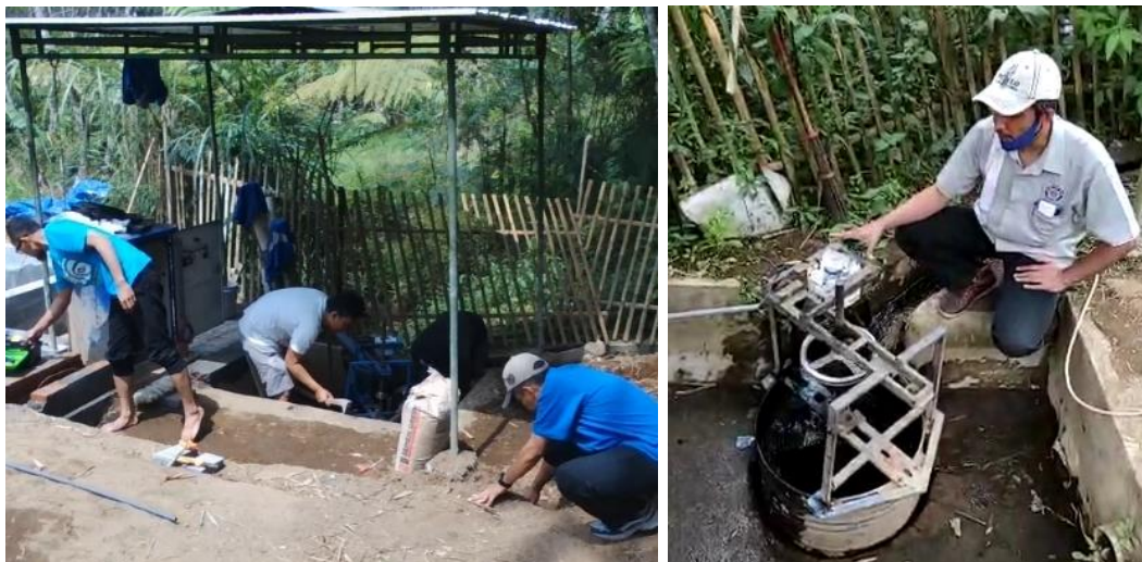
Gambar 1 Pembangunan dan pemasangan pembangkit listrik tenaga piko hidro di Kawasan JLC Kota Batu
