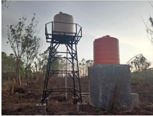
Gambar 5. Bak Penampungan Air
