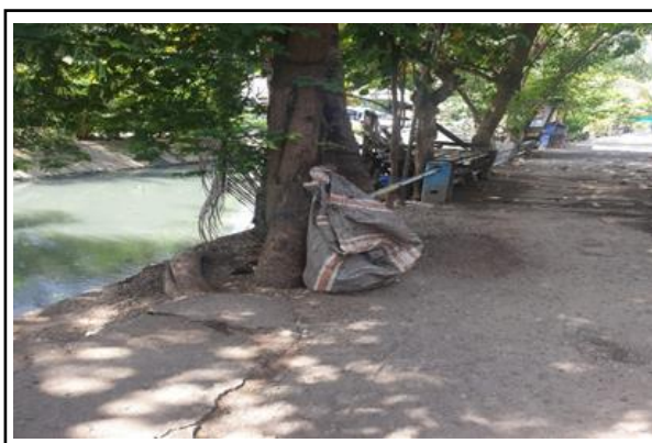
Gambar 1. Wadah Penampungan Sampah yang Rusak.
