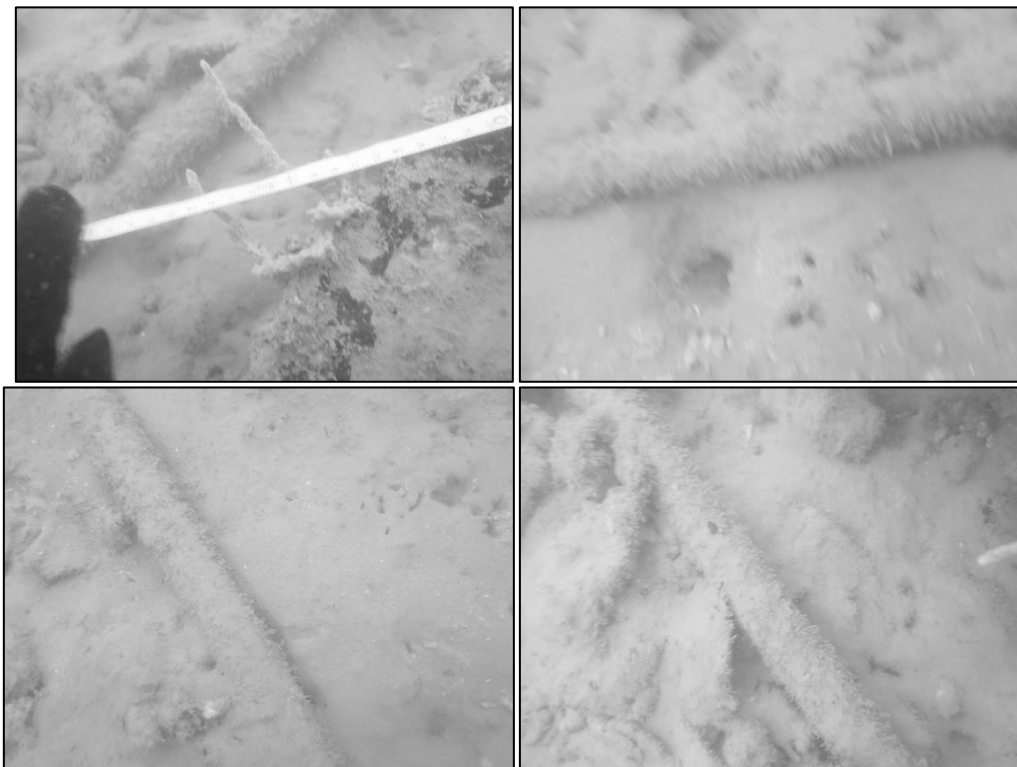
Gambar 12. Foto kondisi kabel bawah laut
