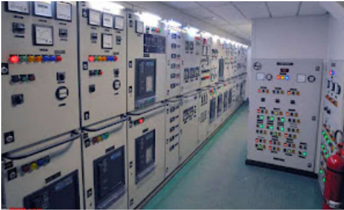
Gambar 2. Ruang kontrol listrik di kapal [7]
