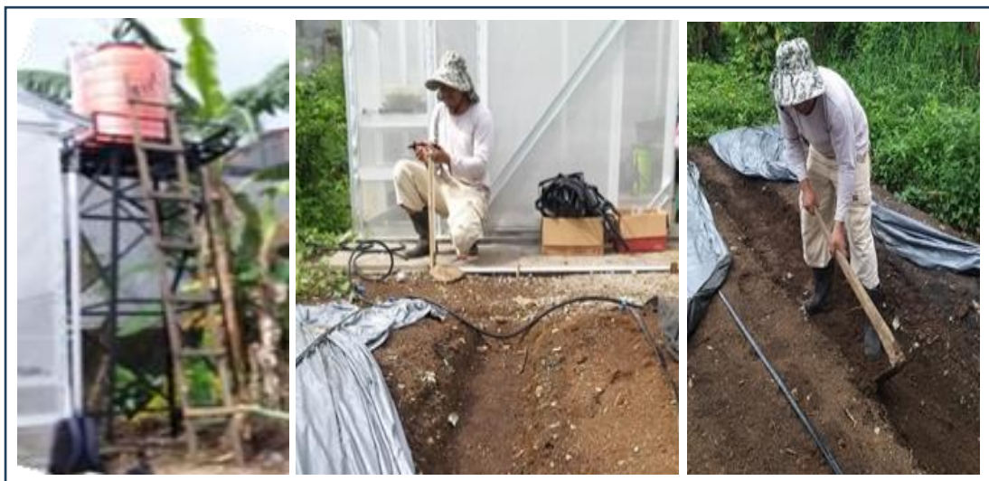
Gambar 8. Sumber air (toren) dan pengaturan pipa PVC.
