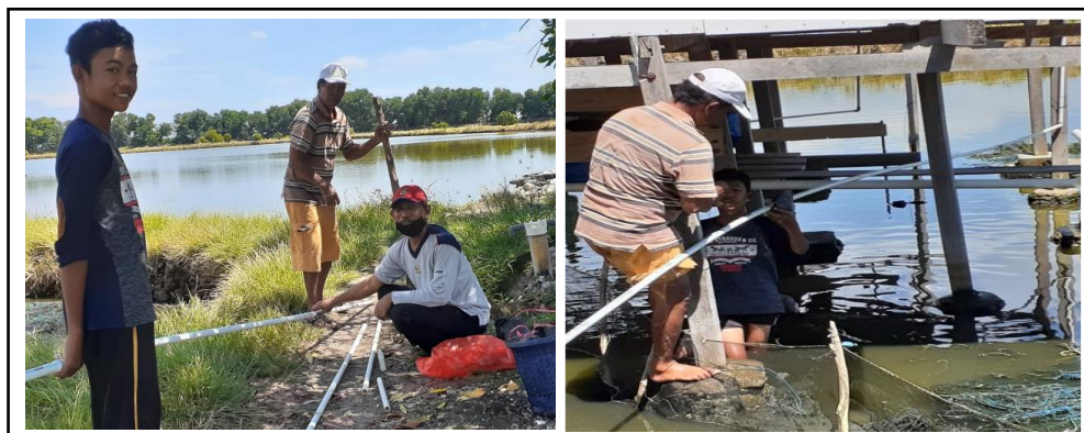
Gambar 3. Penataan dan Pemasangan Instalasi Suplay Air Laut Unit Penangkaran Kuda Laut di Pulau Sabangko.
