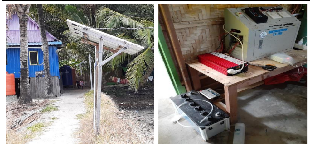
Gambar 6. Instalasi Tenaga Surya untuk Sumber Listrik di Unit Penangkaran Kuda Laut di Pulau Sabangko.
